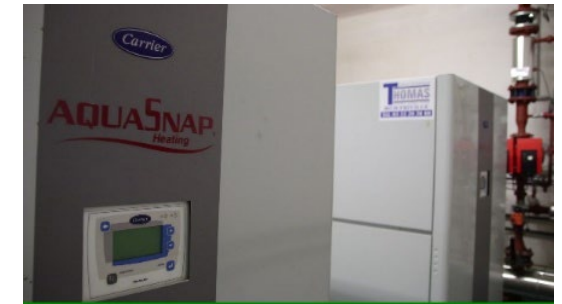
Pompe à chaleur
